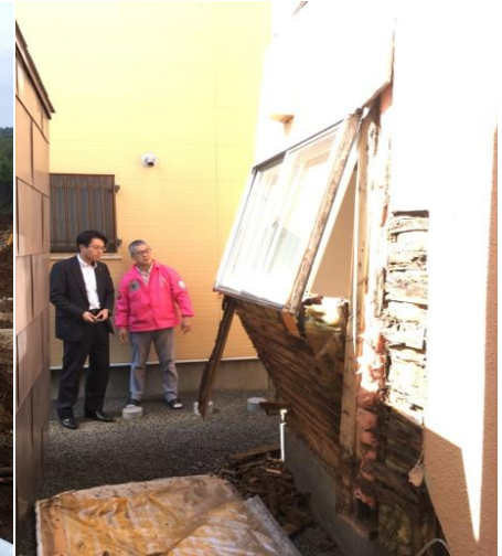
◆札幌市内の被災現場を調査
