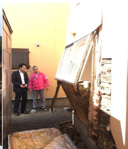
◆札幌市東区の被災現場を調査
